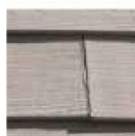
CIMENT FIBRE Fissuration, décoloration, dégazage
