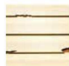
VINYLE Fissuration, décoloration, moisissure, fusion, dégazage
